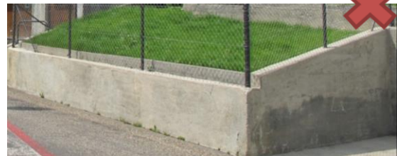
Mur en béton surmonté d'une clôture peu perméable à la petite faune et non-végétalisée
